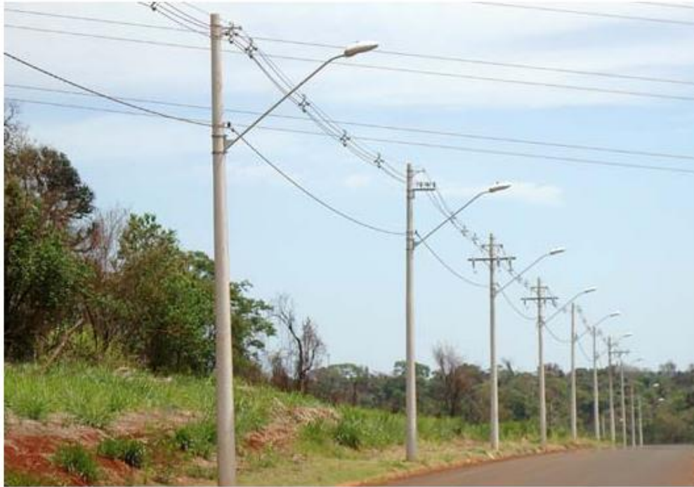
Figura 6 - Rede de distribuição aérea compacta
