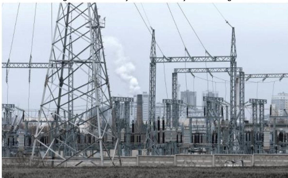
Figura 4 - Subestação de Distribuição de Energia
