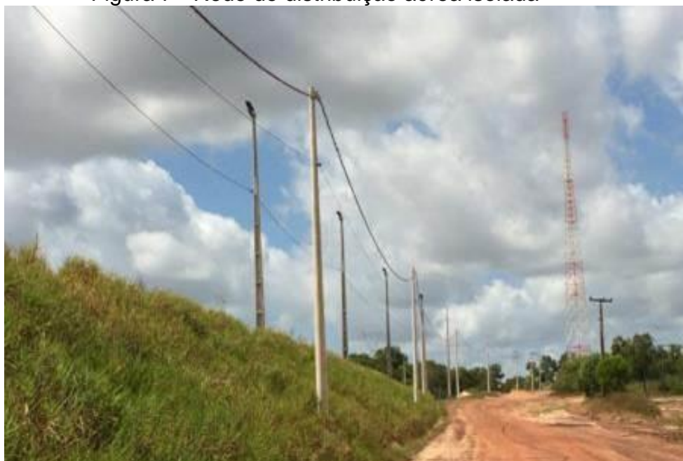
Figura 7 - Rede de distribuição aérea isolada
