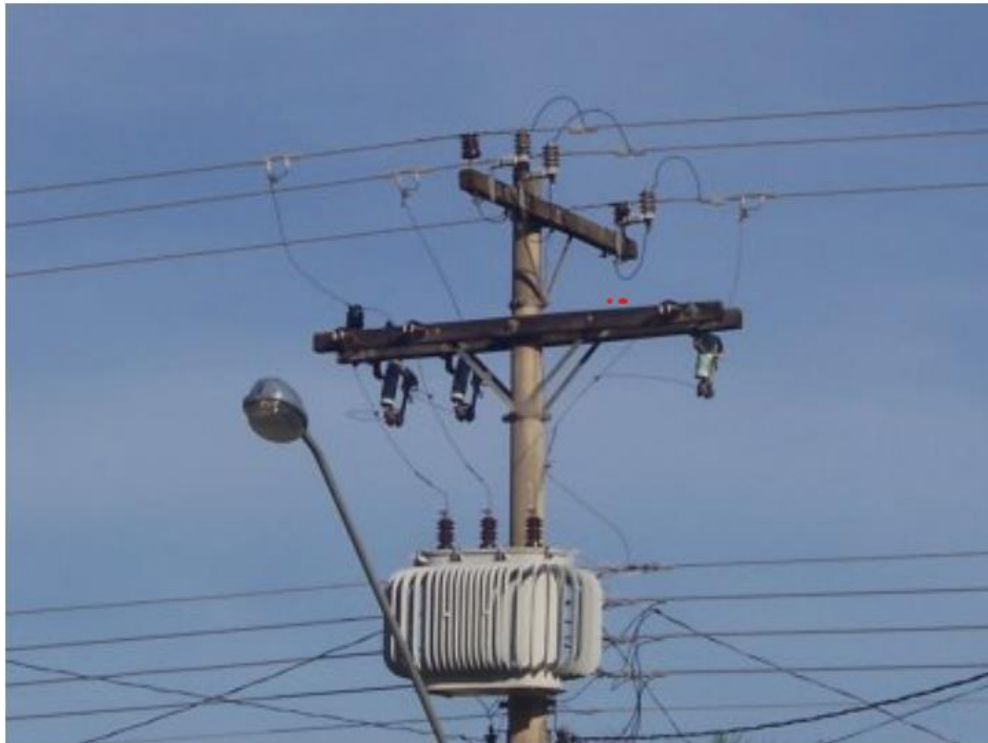
Figura 5 - Rede de distribuição aérea convencional
