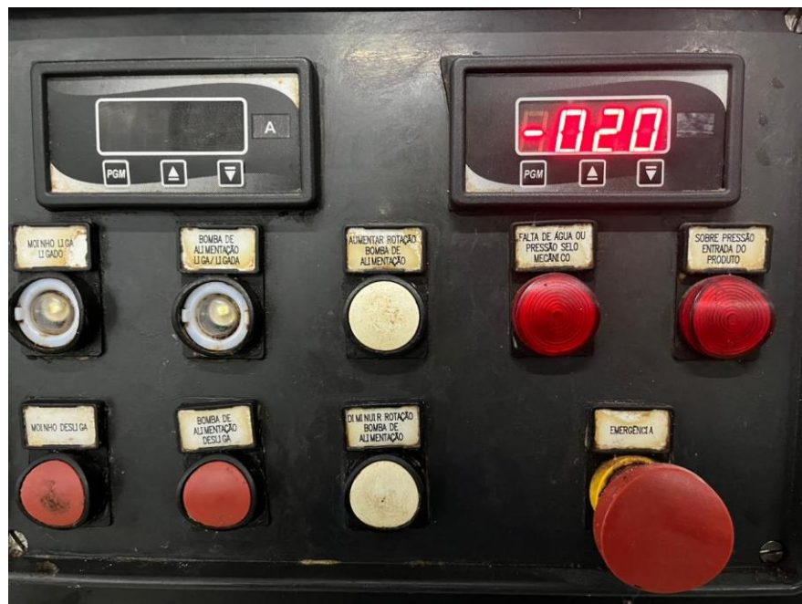
Figura 13 - Painel do sistema de bombas e moagem.
