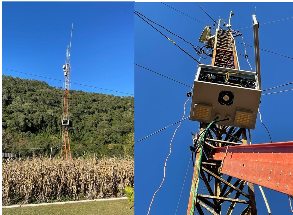
Figura 24 - Vista torre (esquerda) e rack (direita)
