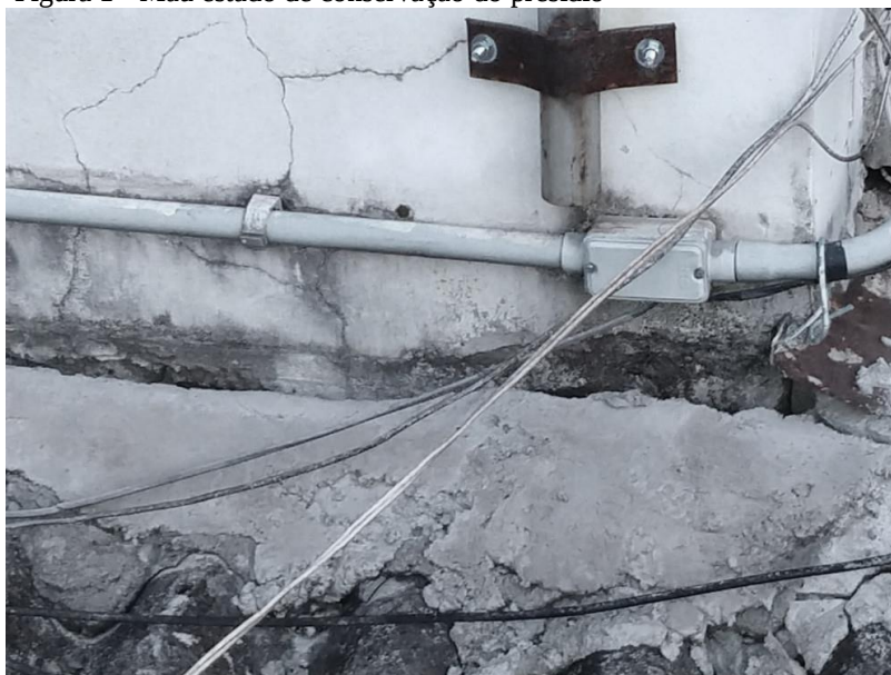
Figura 1 - Mau estado de conservação do presídio
