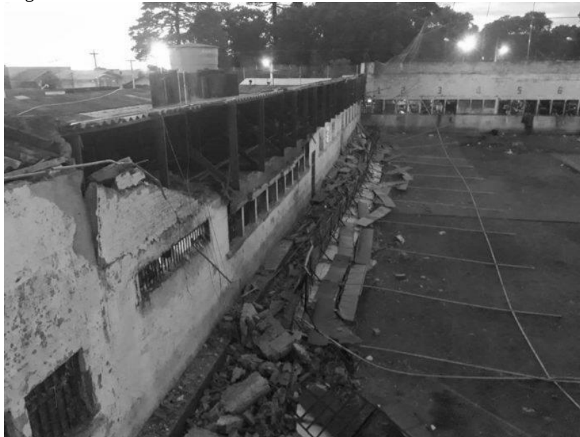
Figura 6 - Muro do Presídio Estadual de Erechim desabou no início de 2019
