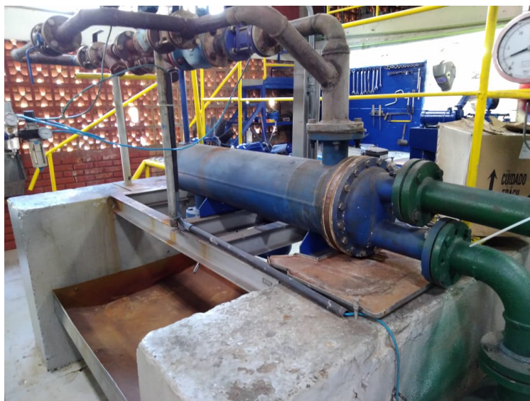
Figura 15 – Trocador de calor do tipo casco e tubos
