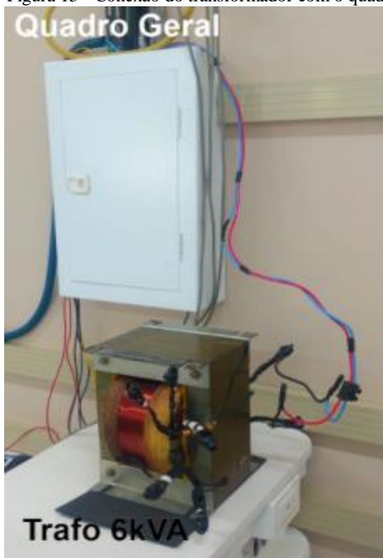
Figura 15 - Conexão do transformador com o quadro geral.
