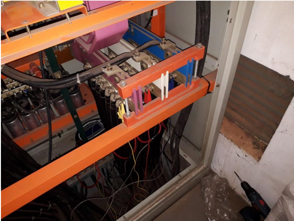
Figura 7: Local de instalação do analisador de QEE.
