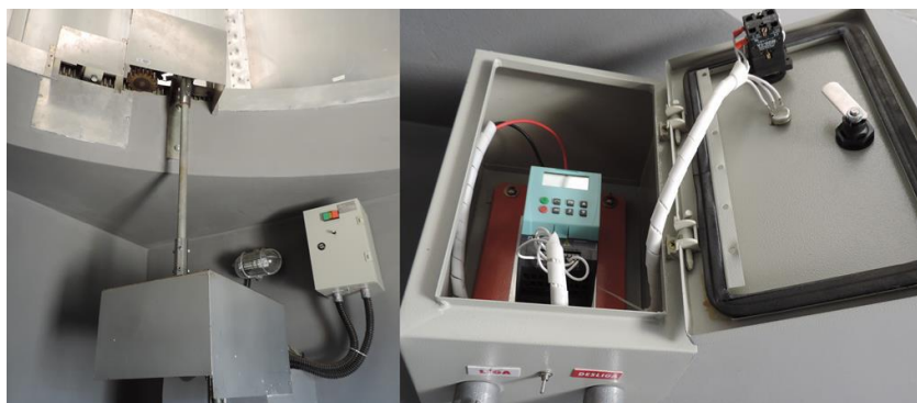
Figura 1 – Sistema de acionamento e controle da cúpula do observatório
