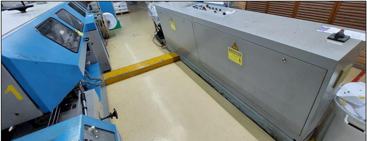
Figura 44 - Painel e caixa de passagem
