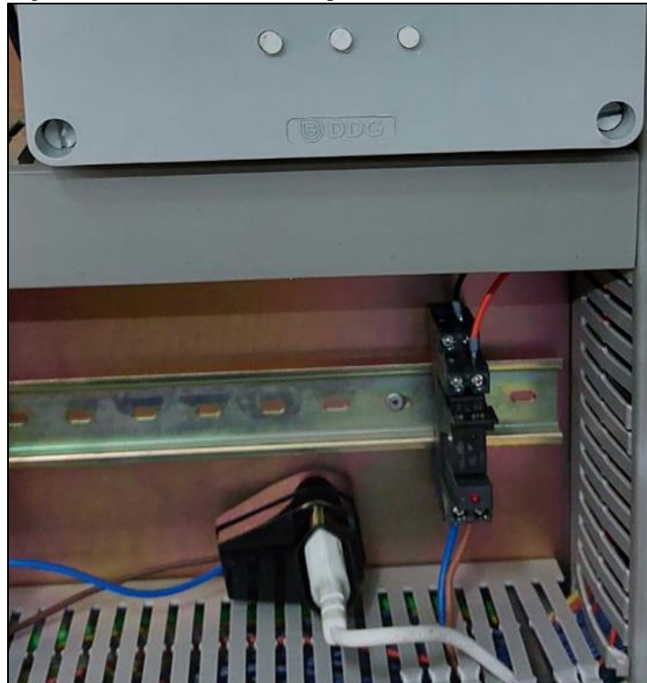
Figura 52 - Relé de acionamento para leitura
