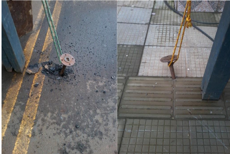
Figura 2 - Pinos danificando o asfalto e a calçada.
