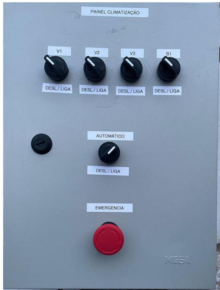
Figura 21 - Tapa do quadro de comando
