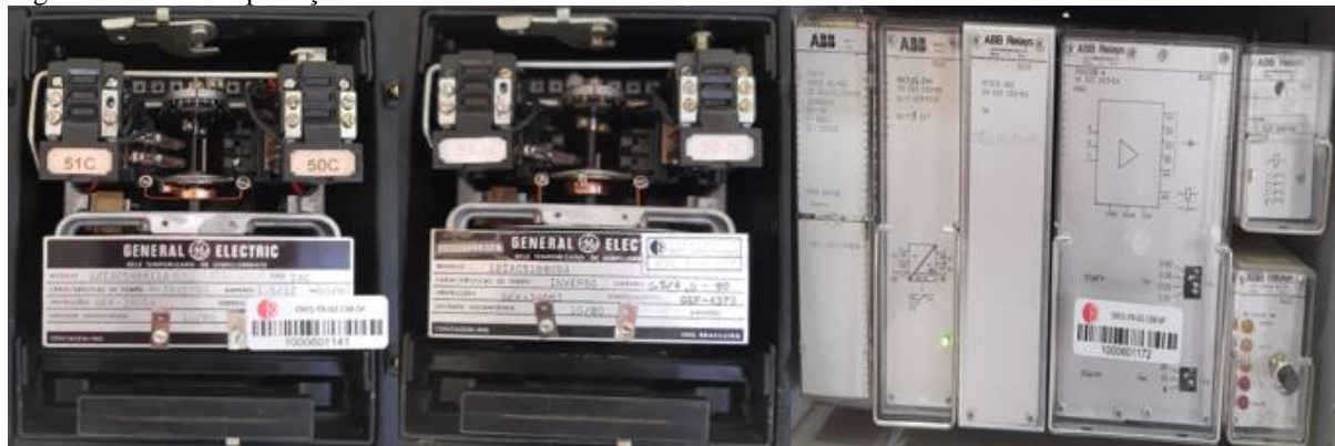
Figura 8 – Relés de proteção existentes
