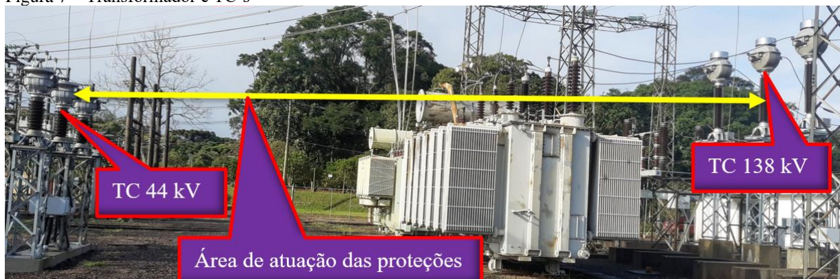
Figura 7 – Transformador e TC's
