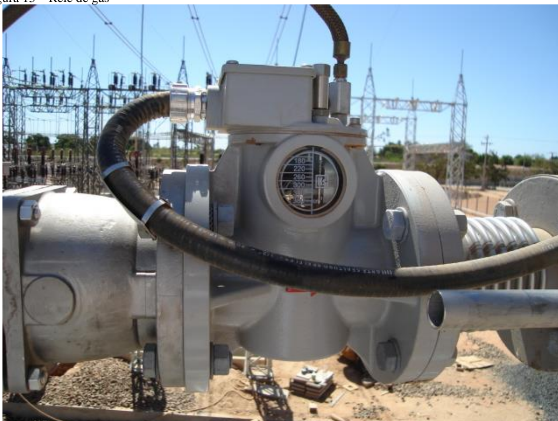
Figura 13 – Relé de gás
