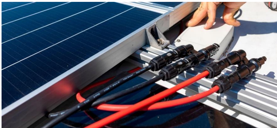
Figura 10 - Cabos para energia solar
