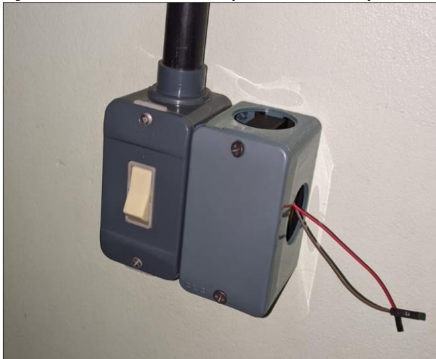
Figura 44 – Posicionamento do condutele para acionamento da lâmpada.
